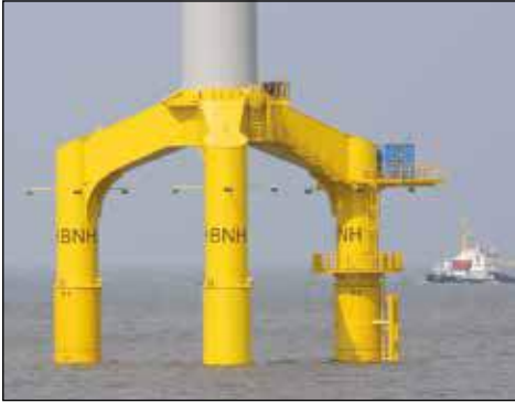
▲ Livellamento di turbine eoliche offshore: Il sistema di sollevamento sincrono di Enerpac ha fornito la soluzione per il livellamento delle basi ad incrocio 80 turbine eoliche.
